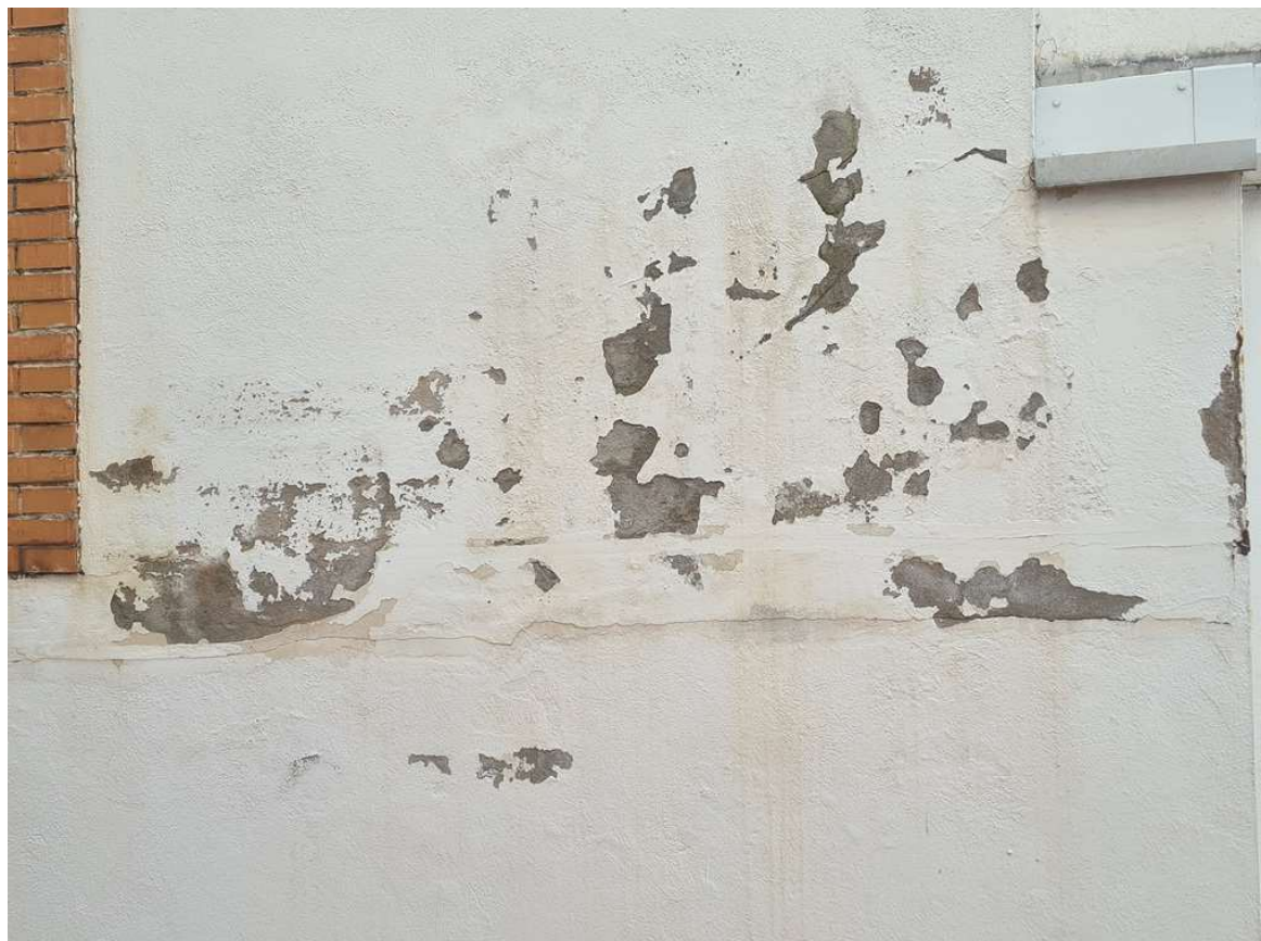
IMATGE 2. Detall de les humitats que s'aprecien al mur de contenció. Data 28-03-2025.
