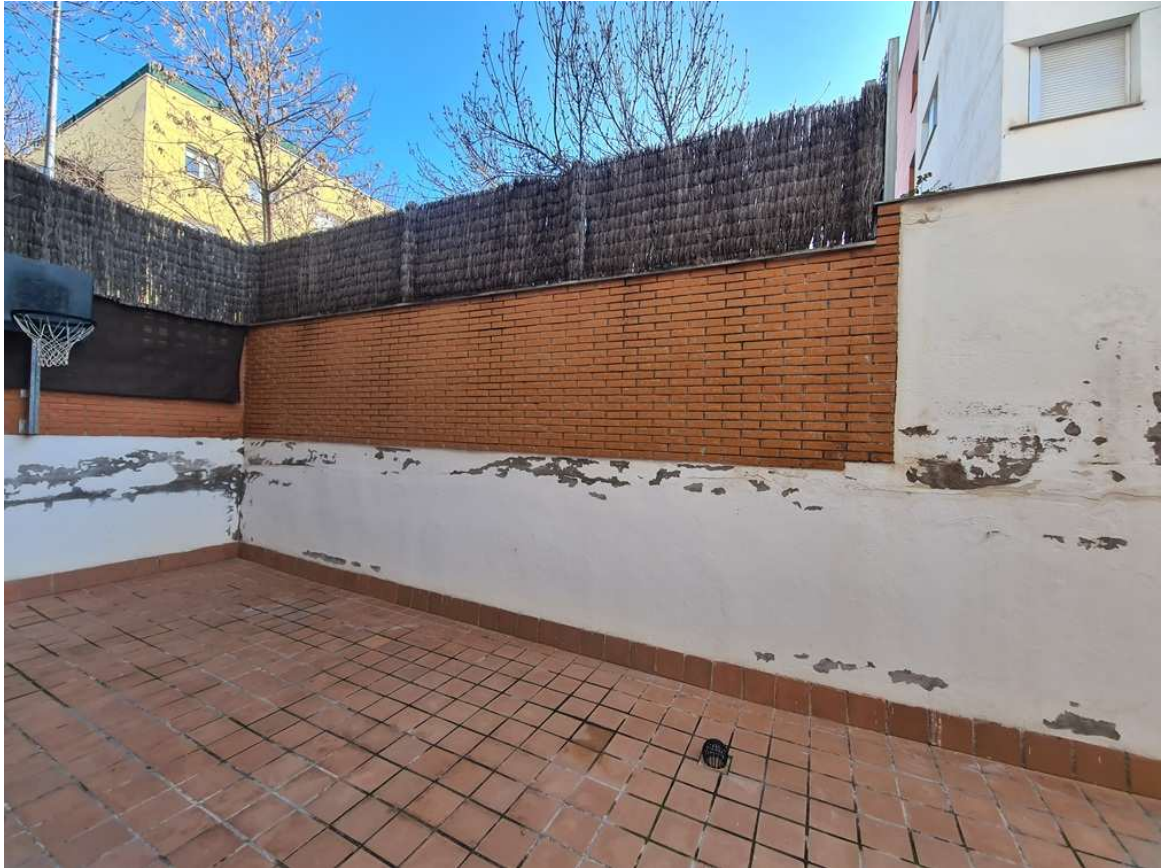
IMATGE 3. Humitats generals als murs de contenció de la finca del C/ Pompeu Fabra 12-14, part de separació amb la via pública. Data 28-03-2025.
