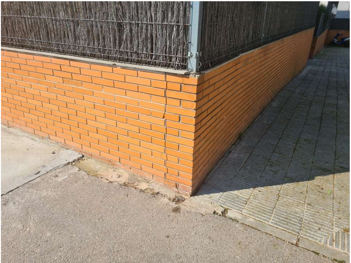
IMATGE 22. Fissura vertical amb el trencament de les peces ceràmiques. Data 28-03-2025.
