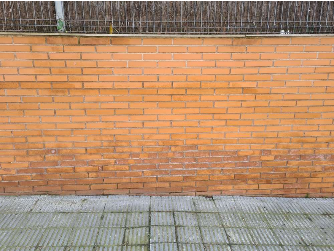
IMATGE 13. Detall de la tanca d'obra vista amb humitats i salinitat a la part baixa i el bombament del paviment de panot. Data 28-03-2025.
