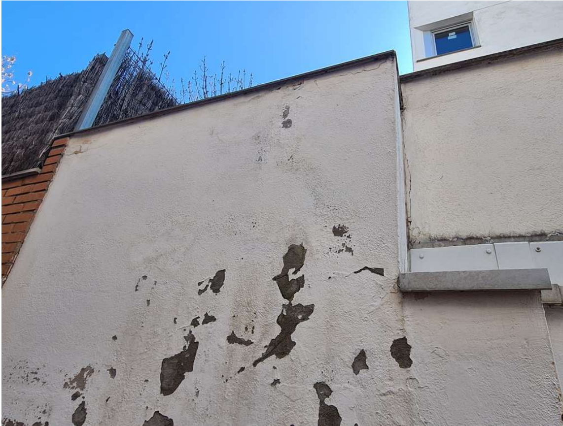
IMATGE 7. Humitats del mur de contenció amb la caiguda del pintat. Data 28-03-2025.
