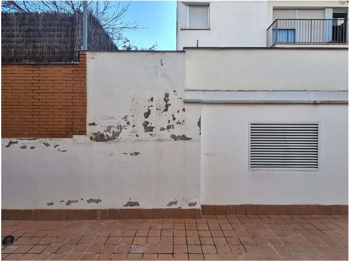
IMATGE 1. Humitats sobre el mur de contenció des de la finca C/ Pompeu Fabra 12-14. Data 28-03-2025.
