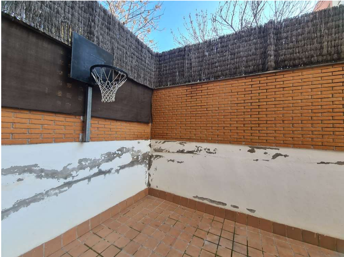
IMATGE 5. Detall de les humitats existents als murs de contenció. Data 28-03-2025.
