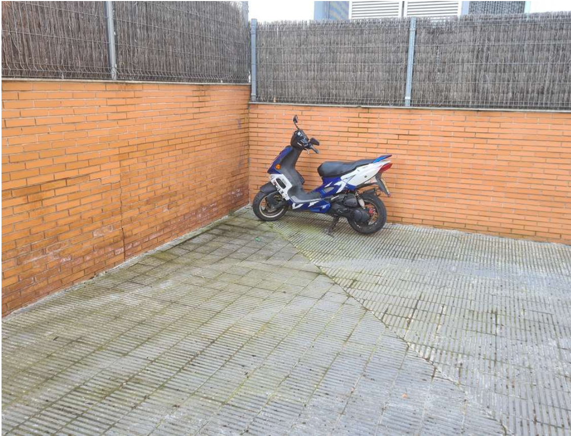
IMATGE 10. Tanca de separació a la zona de la cantonada, on s'observa humitats al mur d'obra vista i el bombament/deformació de l'acabat de la vorera. Data 28-03-2025.
