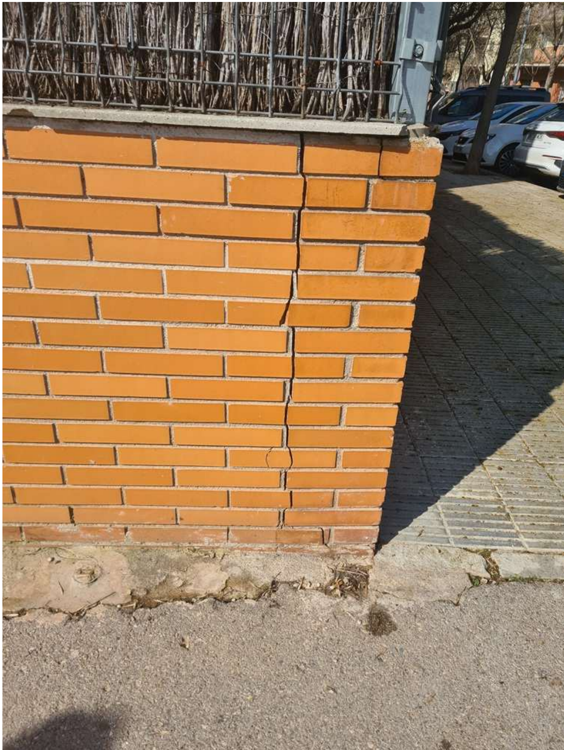
IMATGE 23. Detall de la fissura vertical i el trencament de les peces ceràmiques de la tanca perimetral de la finca. Data 28-03-2025.
