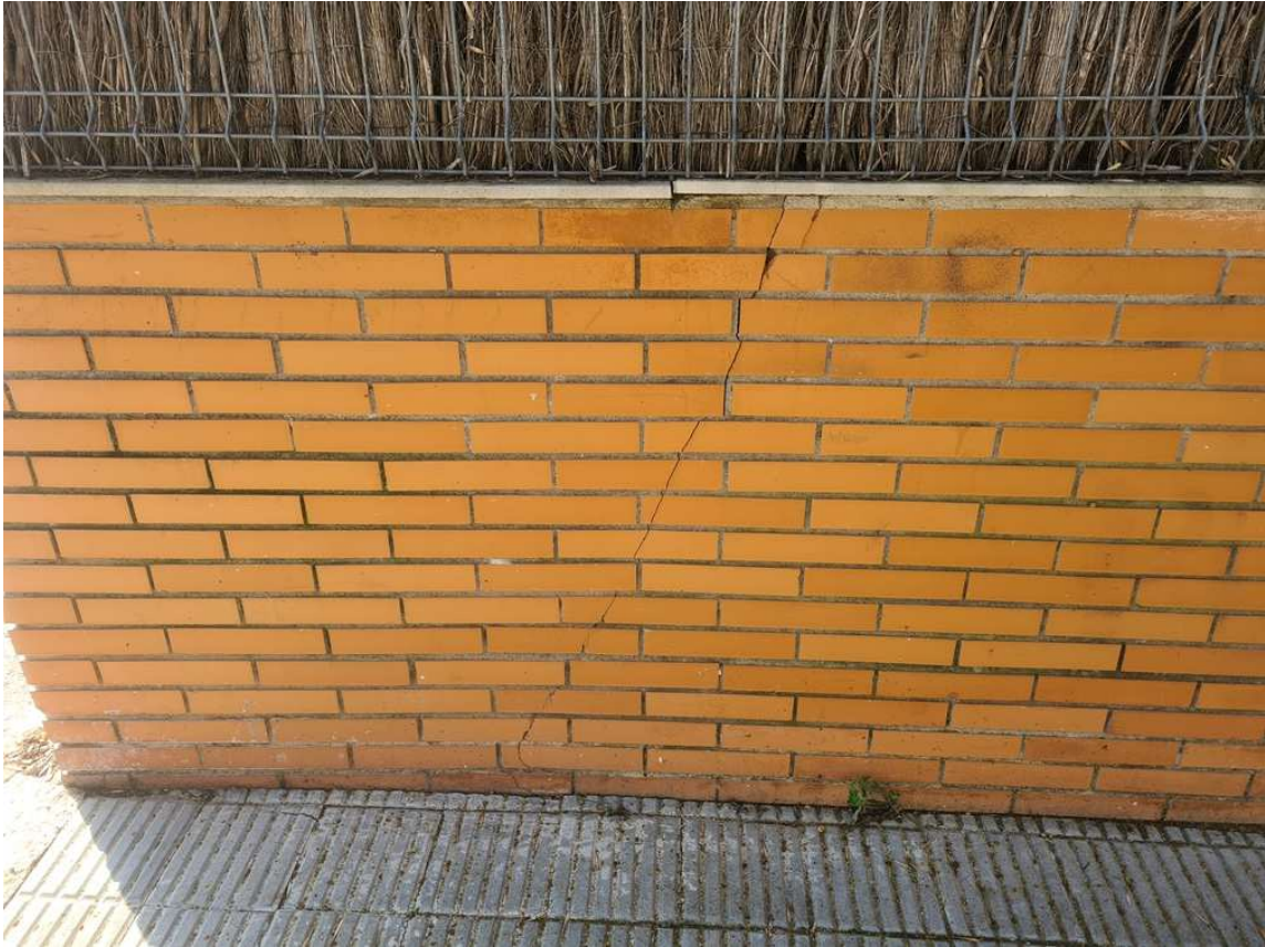
IMATGE 21. Fissura en diagonal amb el trencament de les peces ceràmiques. Data 28-03-2025.
