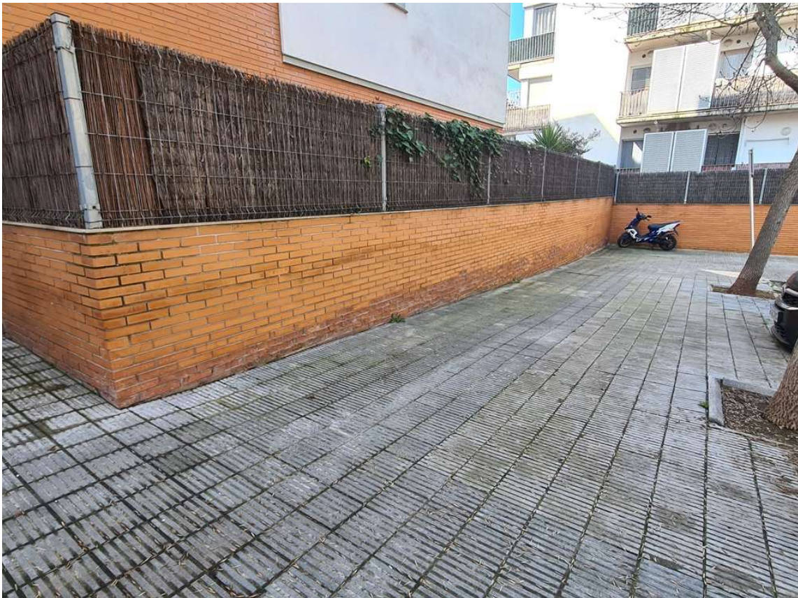
IMATGE 9. Tanca de separació a la façana nord (C/ Pompeu Fabra, 16) on s'aprecien les humitats a la part baixa i certs bombaments de la vorera. Data 28-03-2025.
