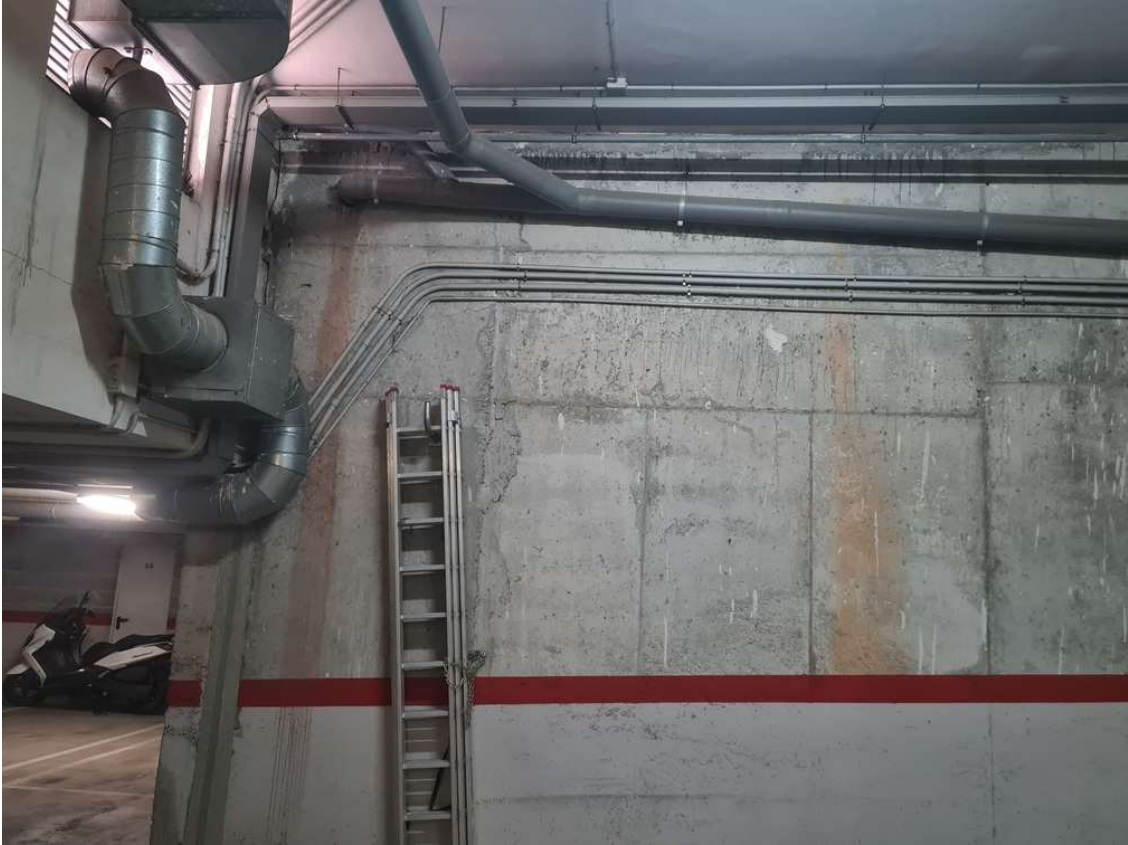
IMATGE 20. Foto del garatge just sota la terrassa i jardí, on s'aprecia el tub de desaigua de la zona del jardí. Data 28-03-2025.
