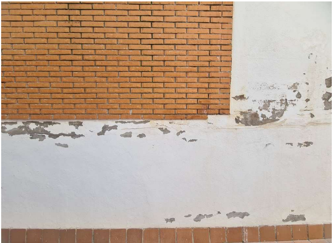
IMATGE 4. Detall de les humitats del mur de contenció. Data 28-03-2025.
